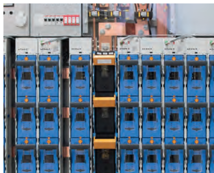
Oszczędność miejsca i bezproblemowa ochrona elektronicznych systemów pomiarowych w rozdzielnicach
