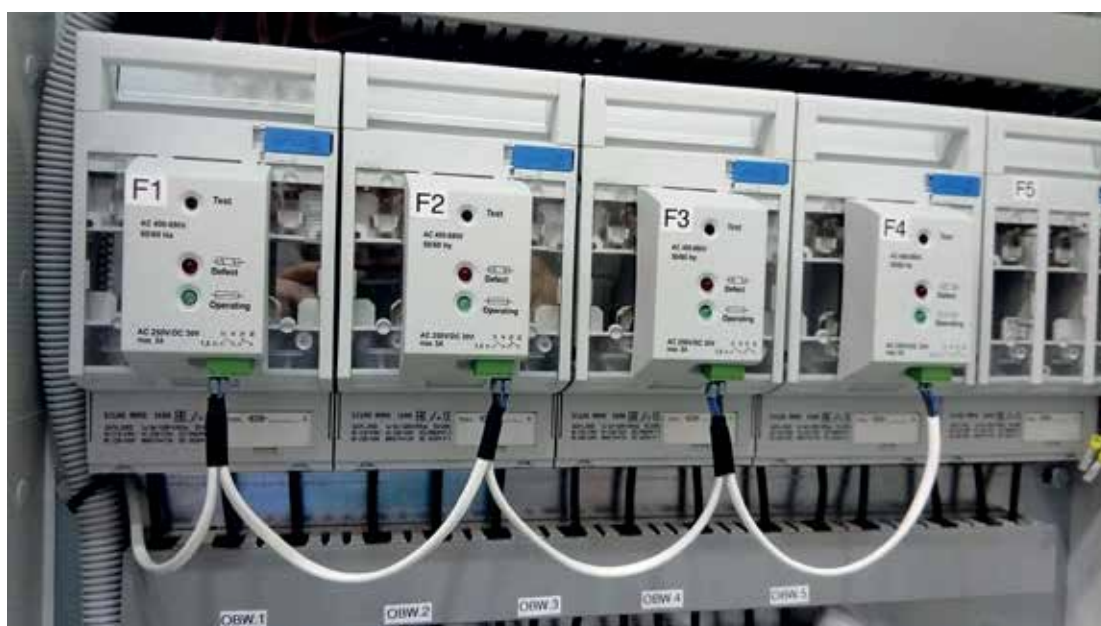
9. Пример разъединителей серии SILAS с электронной системой мониторинга предохранителей, примененных в шкафах управления освещением.
