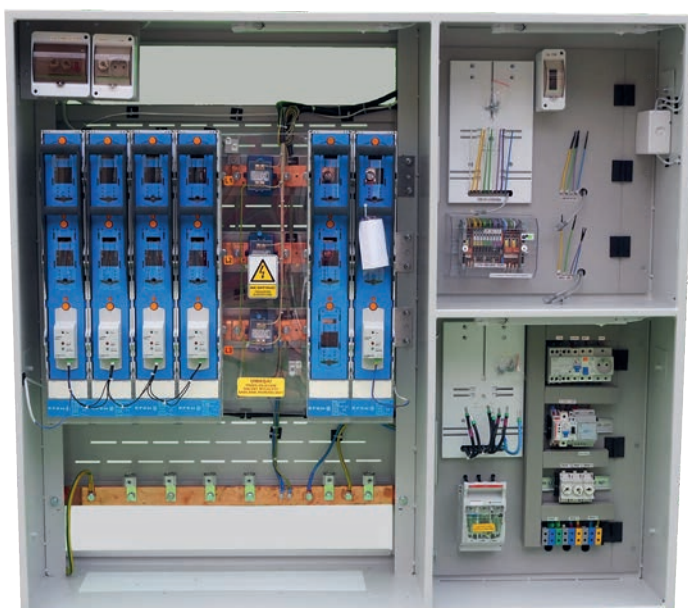
Zdj. 6. Przykład rozłączników bezpiecznikowych NSL E3 z kontrolą przepalenia wkładek bezpiecznikowych w rozdzielni produkcji PRE EDWARD BIEL
