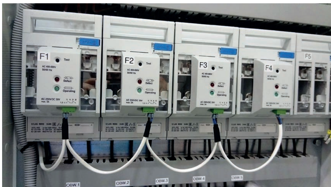
Zdj. 9. Przykład rozłączników bezpiecznikowych SILAS z kontrolą przepalenia wkładek bezpiecznikowych zastosowanych w szafach sterowania oświetleniem
